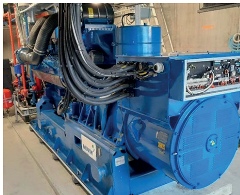
L'un des moteurs de cogénération.
