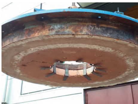
Ancien réfractaire fissuré
